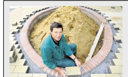
Siegfried Bauchler arbeitet derzeit am neuen Sandkasten auf dem Krippenkinderspielplatz in der Langenwolmsdorfer ASB-Kita Schlumpfenland. Foto: Unger
